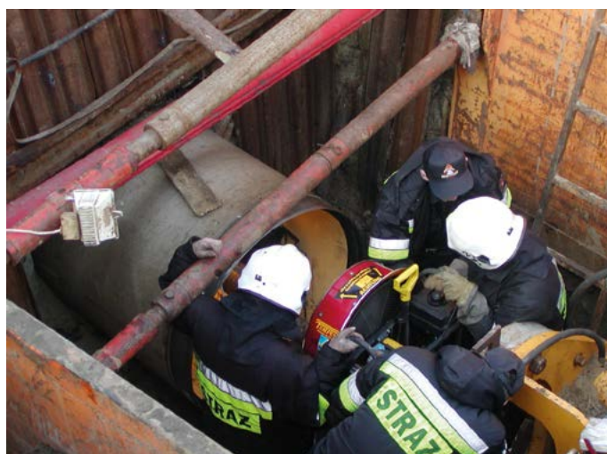
Figure 6. Providing air to hard-to-reach places using a mobile fan Rycina 6. Napowietrzanie trudnodostępnych miejsc z wykorzystaniem mobilnego wentylatora
