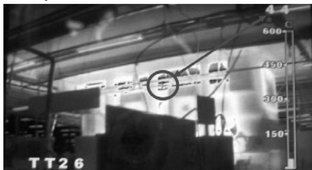
Ryc. 4. Kontrola temperatury przewodów wentylacyjnych. Kolor fioletowy na termogramie obrazuje najwyższą temperaturę. W punkcie pomiarowym temperatura wynosi 44°C
