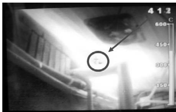
Ryc. 8. Termogram górnej powierzchni przewodu kominowego kotła. Jaśniejszy odcień obrazuje wyższą temperaturę
