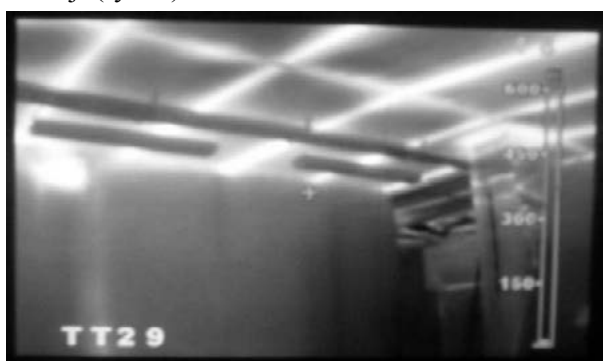
Ryc. 7. Termogram sufitu podwieszanego. Jasny odcień obrazuje podwyższoną temperaturę
