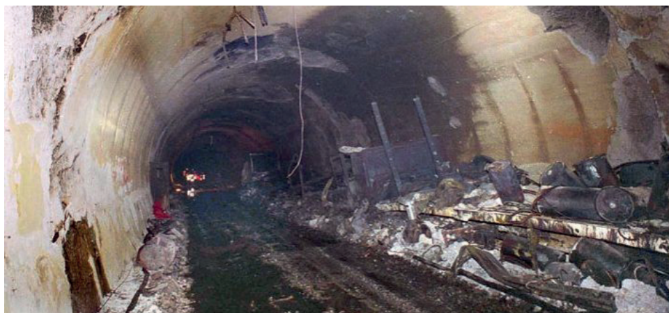
Rycina 3. Widok tunelu Mont Blanc po pożarze [15]
