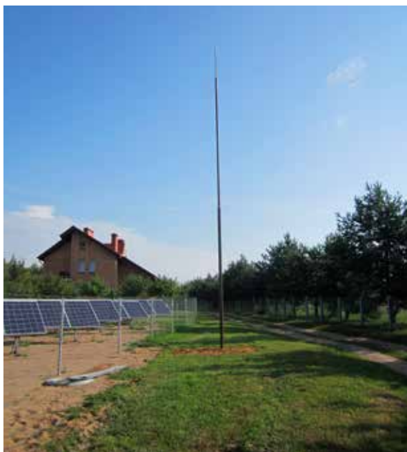
Рис. 6. Смонтированный молниеотвод с повышенными характеристиками устойчивого функционирования на площадке для проведения исследований в д. Боровляны Минского района в период наблюдений
