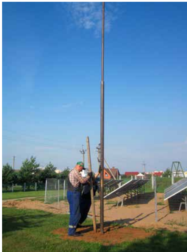
Рис. 5. Уплотнение грунта в месте установки молниеотвода с повышенными характеристиками устойчивого функционирования на площадке для проведения исследований в д. Боровляны Минского района Fig. 5. Soil compaction in the place of installation of a lightning conductor with enhanced resistance level on the testing site in the village of Borovlyany, Minsk region
