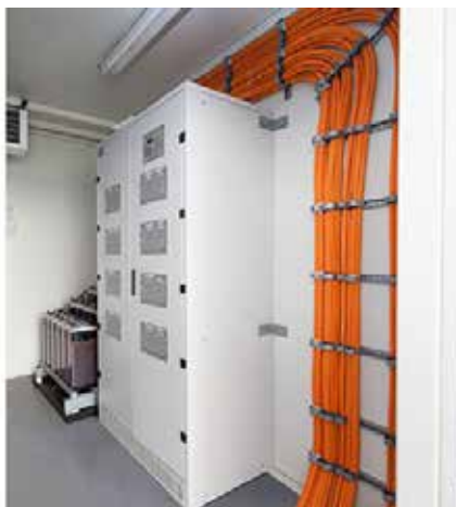
Rycina 9. Przykład nagromadzenia dużej ilości kabli ognioodpornych w pomieszczeniu
