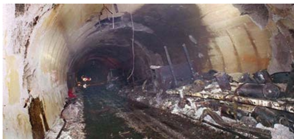
Figure 1. View of the Mont Blanc tunnel after the fire of 1999 Rycina 1. Widok tunelu Mont Blanc po pożarze w 1999 roku
