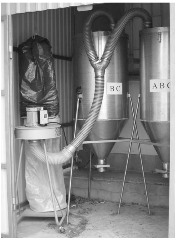
Fot.5 Silosy na proszek
