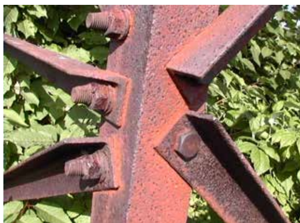
Ryc. 1. Widok skorodowanych kątowników słupa Fig. 1. A view of corroded pylon metal angle brackets
