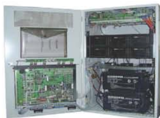
Centrala dźwiękowego systemu ostrzegawczego
