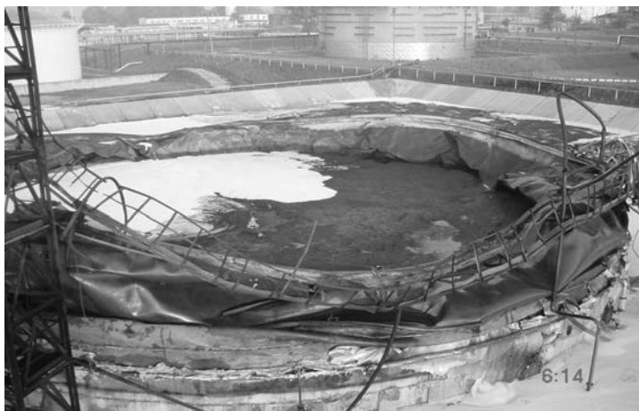
Ryc. 6. Zbiornik po pożarze w Rafinerii Trzebinia.
